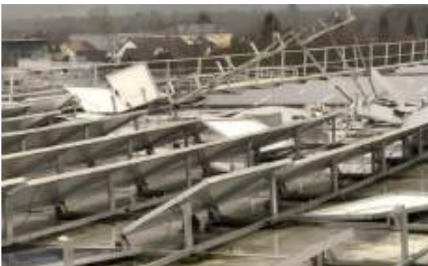
Abbildung 4: Windgeschädigte PV-Module und -Rahmen. (Quelle: Zurich)
